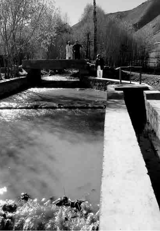
カマティ川から灌漑のために水を取り入れる取水工 (アフガニスタン、パルミヤン州フォーディ渓谷)。©FAO/H. Farhadi
