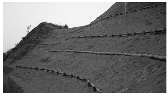
図8 日本の治山施設の1つである丸太筋工。低コスト、材料調達、施工性の点から、ベトナムへの適用が期待される
