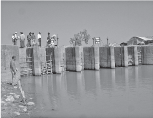
写真3 改修が必要な水門
