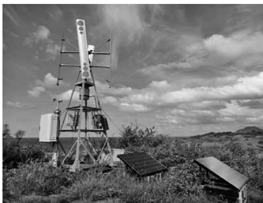
写真4 垂直軸風車（乾燥地研究センター）
